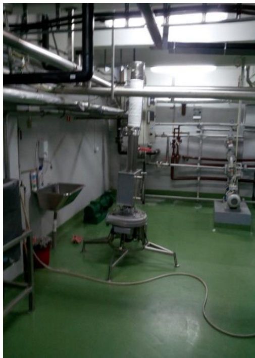
Pobór próbki aerozoli powietrza atmosferycznego w Przepompowni przy hali obektu 35
